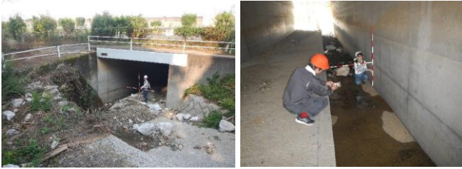
図 5 高速道路カルバートにおける流下痕跡
