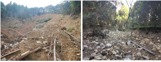
図 4 流域内状況 (左：崩壊地、右：治山施設背面)
