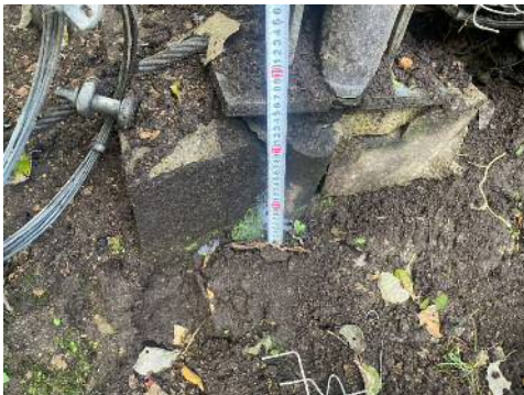
図-4 調整モルタルの破損
