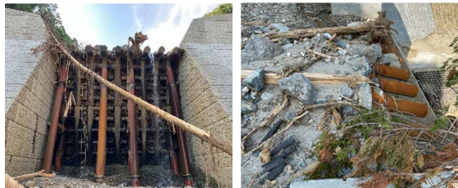
図-3 流木・土砂の捕捉状況
