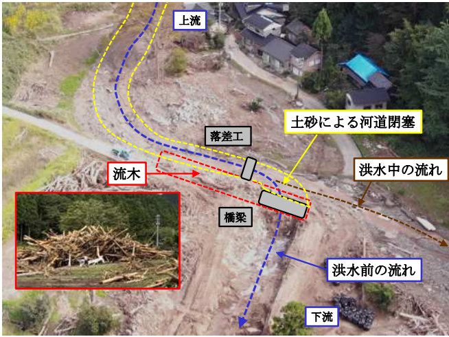
図1 輪島市池田地区の橋梁周辺の被災後の様子
