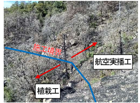
写真-5 施工境界の例
