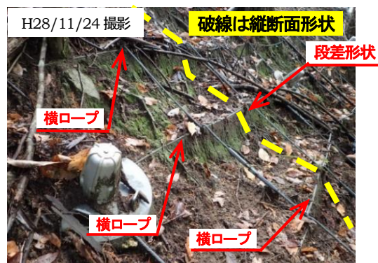
写真 1 対策斜面で確認された段差形状
