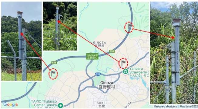
図-3 貯水式 IoT 雨量計の設置位置
