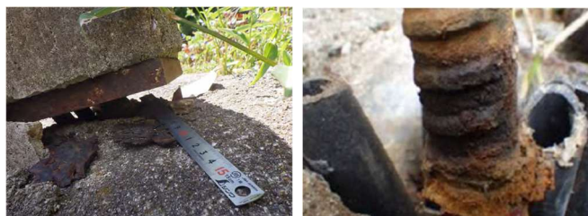
写真1 アンカーの変状写真
