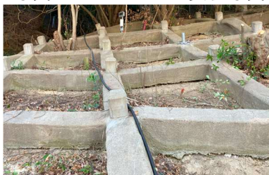
写真2 法枠工の変状写真
