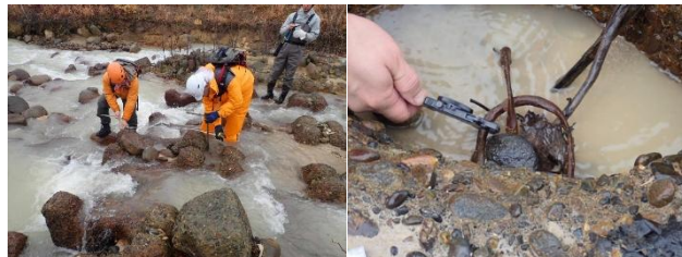
写真-1 連結金具の腐食状況
