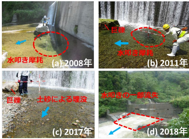
写真 2 a~d ナンノ谷砂防ダム 3 号における 2003, 2011, 2017, 2018 年度点検時の水叩きの様子
