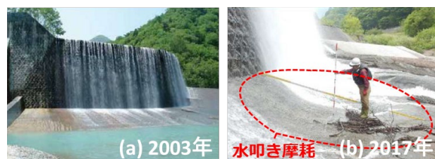
写真1 a, b 門森沢砂防堰堤における2003, 2017年度点検時の水叩きの様子
