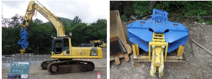
図5 コンクリートブロック据付に用いた無人バックホウと把持装置
