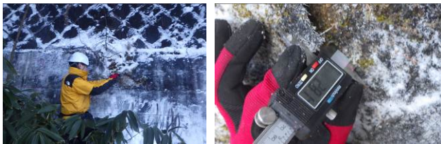
左:塗装厚の全損箇所、右:デジタルノギス計測状況
