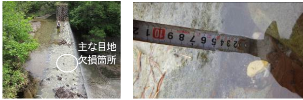
左:水通し(右岸側から)、右:目地欠損4cm
