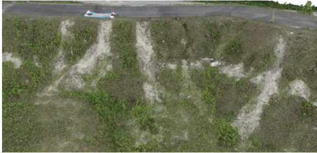
図 2 法面の変状 (UAV による確認)
