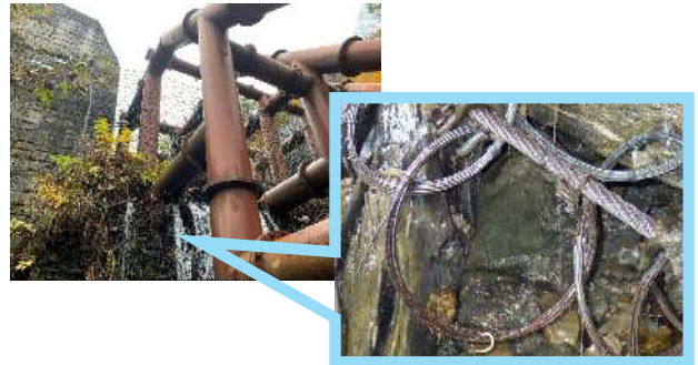
図 4 土石流・流木捕捉＋流水部リングネット状況
