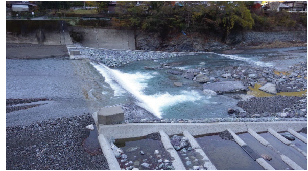
写真5 2019年10月の出水で越流面の石張り崩壊
