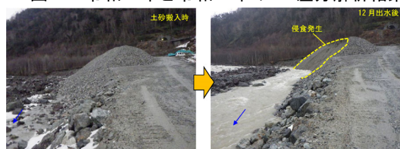
図 3 令和 5 年 12 月出水による置き土の侵食状況
