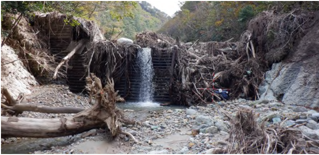
写真 2.6 真浦地区の既設鋼製柵谷止工被災状況
