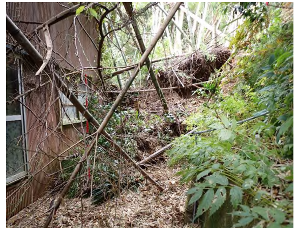
写真 2.11 山中反甫地区の人家背面の不安定土砂
