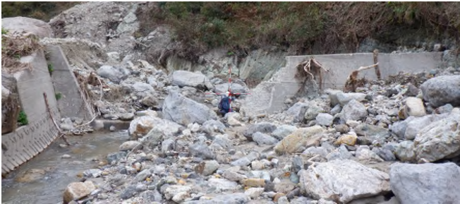
写真 2.7 真浦地区の既設コンクリート床固工被災状況
