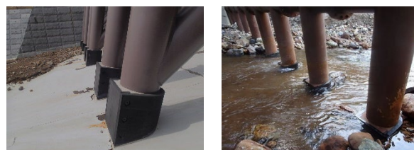
図 2 腐食対策先行事例
