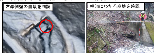
図4 地形解析図・現地による損傷（崩壊）の把握
