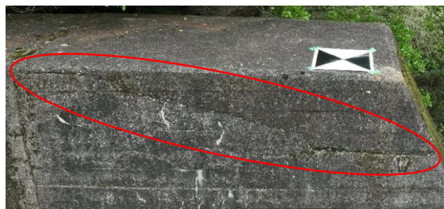
図3 UAV撮影画像から確認できる砂防堰堤前面亀裂
