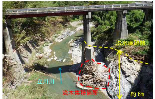
写真-1 川口橋の流木塊残存状況
