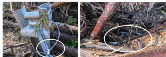
写真-2 ネット構造物の現状（2024/10/18 撮影）
