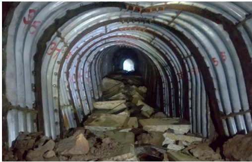
写真3 坑口付近のトンネルの変状
