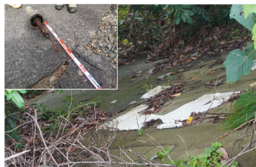
写真2 アンカーの抜け出し箇所と抜け出したアンカー
