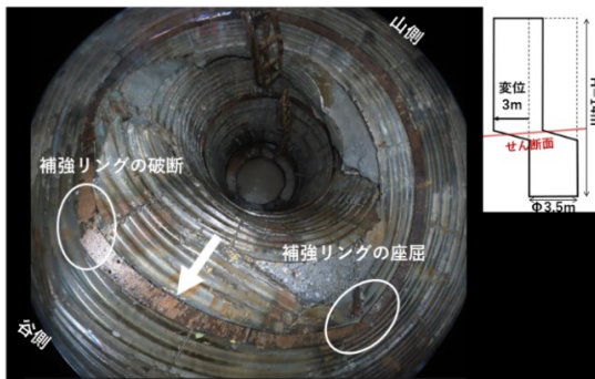
写真4 井筒のせん断変形状況
