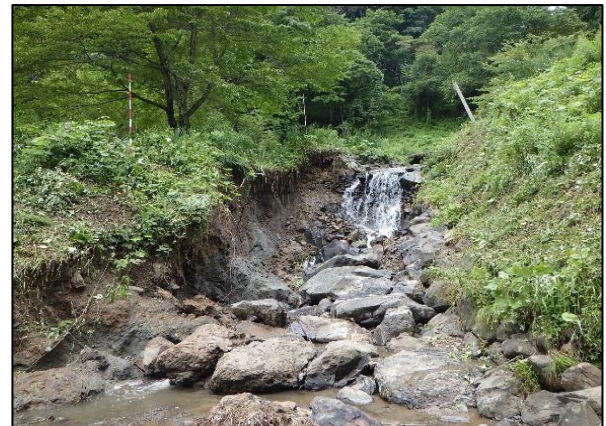
写真2 16号石張水路工（被災後）
