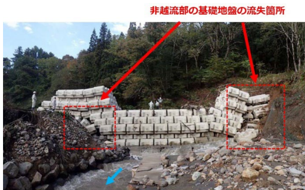
写真3 非越流部の基礎地盤流失の事例 (土砂流出時)
