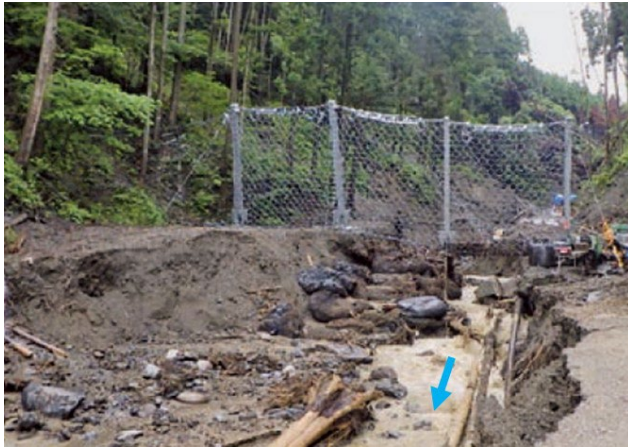
写真1 柔構造物の基礎地盤流失の事例
