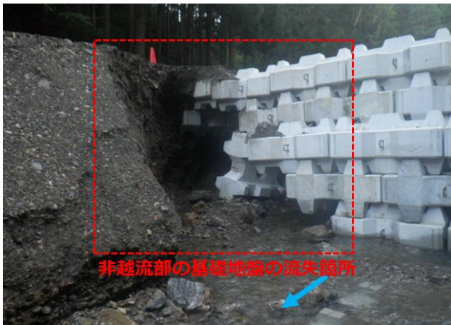
写真2 非越流部の基礎地盤流失の事例（平時）
