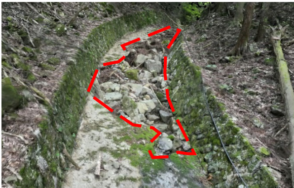
図-3 変状部のモデル(護床工の欠損)
