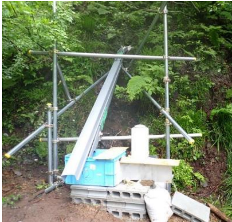
写真1 湧水観測のパーシャルフリューム
