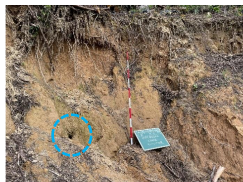
図-6 崩壊地内のパイピングホール
