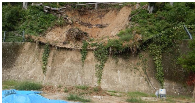
図-2 落石防護柵の変形状況
