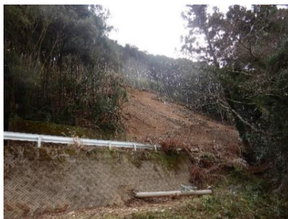
図1 調査した崩壊地
