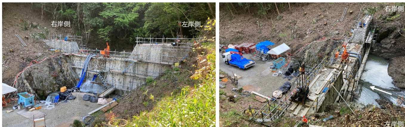
写真-1 対象施設におけるグラウト注入工の実施状況(左:正面側から望む、右:左岸側から望む)(令和5年5月)
