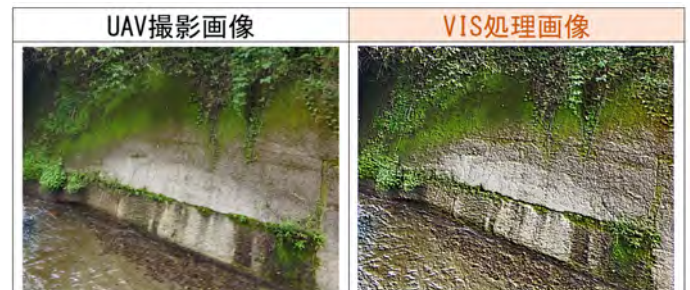
図4 ひび割れに対するVIS処理
