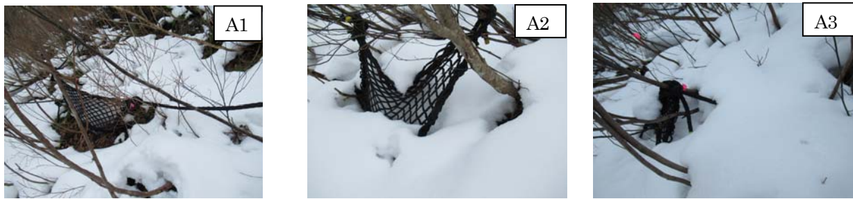
図5 小型構造物(ネット構造物)の積雪状況
