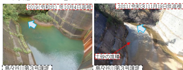
図-6 島々谷川第3号砂防堰堤の直下流の状況 (左:出水前, 右:出水後)
