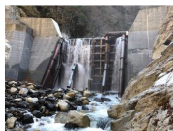
写真-1 被災景況
