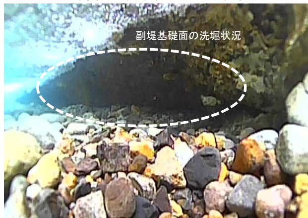
写真-3 基礎部の洗堀状況（水中カメラ画像）
