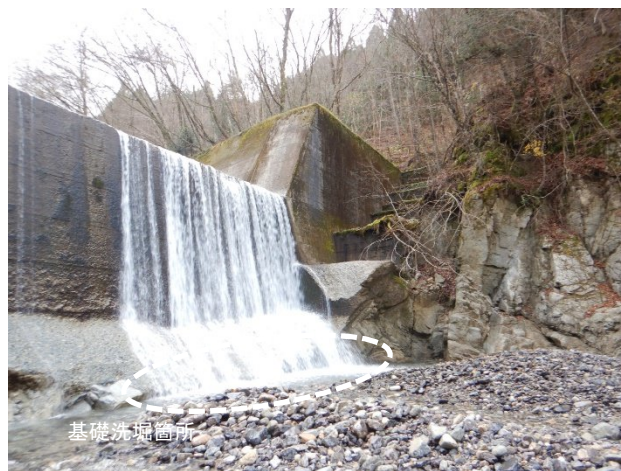
写真-2 副堰堤正面（洗堀部）
