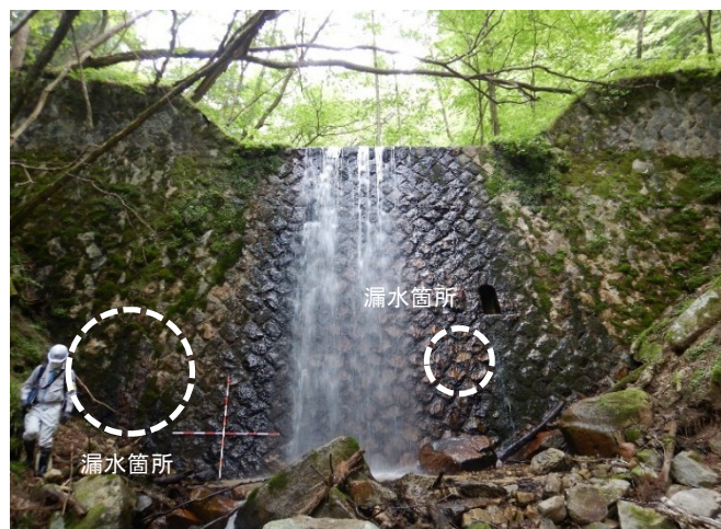
写真-5 堰堤正面（漏水箇所）
