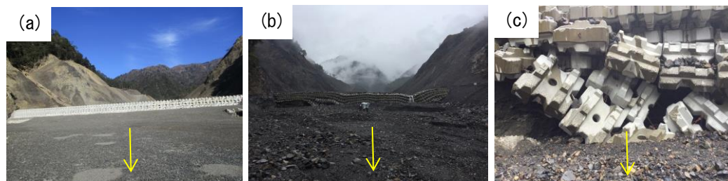
写真-2 栗平地区におけるブロック積み工の(a)変形・流出前(2016年1月24日撮影)、(b)変形・流出後(2021年3月31日撮影)、(c) (b)の河床付近拡大写真(2021年3月31日撮影)。黄矢印は流向を示す。
