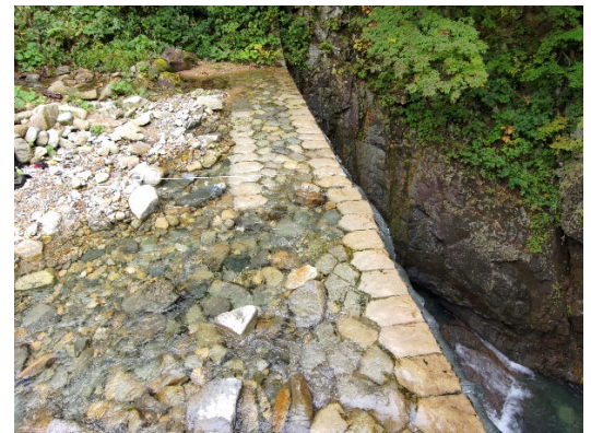
写真 5. J2 による近接撮影写真 (写真 3 の植生の下。堰堤天端の損傷)
