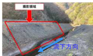
図5 赤谷地区湛水池に接続する河岸斜面 (事例2)
