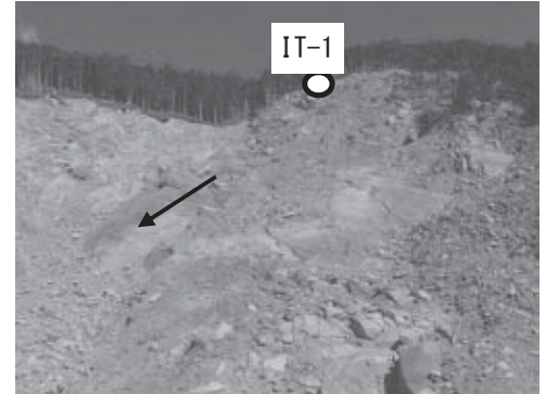
写真-2. 不安定斜面下方斜面の露岩傾斜方向
