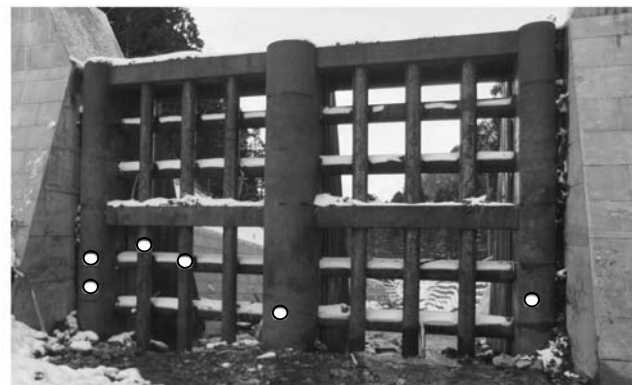
写真-3 機能部材凹み変形箇所
