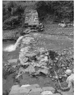
図-2 豪雨による被災状況 (鎌倉沢川第一号堰堤)
