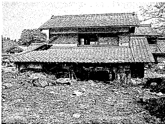
写真5.一乗谷川被害状況①
