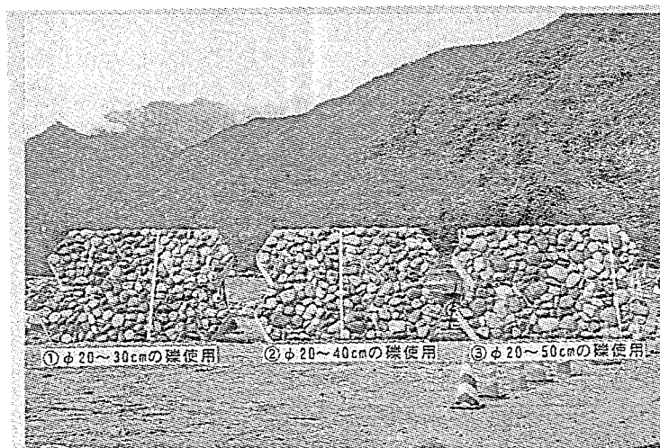
写真.3 テクスチャモデル（修景用型枠）
