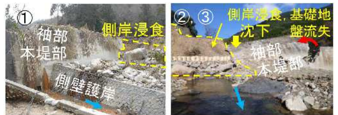
写真3. 想定される損傷の段階別写真-3
