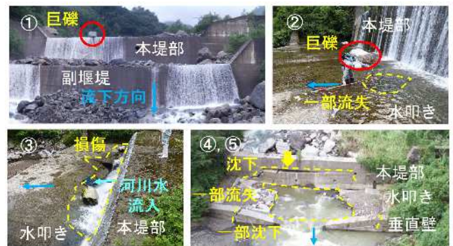
写真 1. 想定される損傷の段階別写真-1
