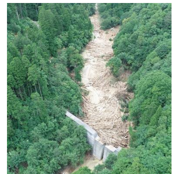
図3 大赤川3号堰堤の流木捕捉状況（青森県提供）
