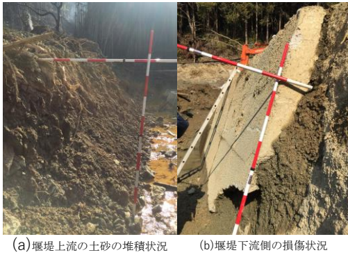
図3 堰堤の破壊状況
