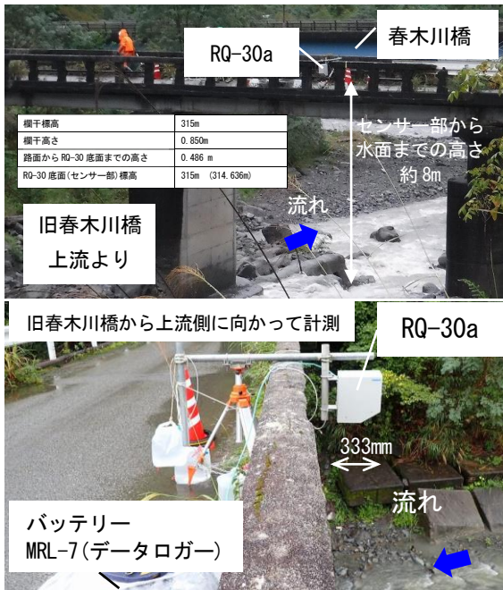
図4 RQ-30a 設置状況
