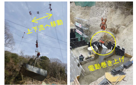
写真 1 H 型索道 写真 2 改良ベッセル
