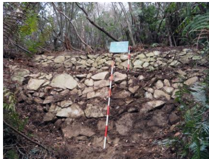
写真-4 最大規模の谷止工
