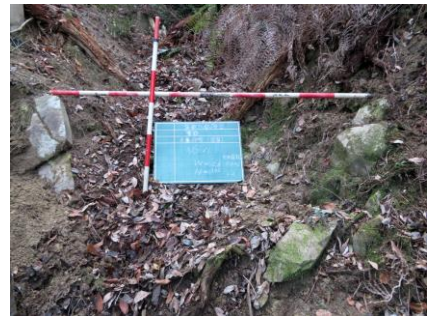
写真-5 崩壊した谷止工
