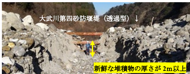
図 4 満砂状態となった大武川第四砂防堰堤
